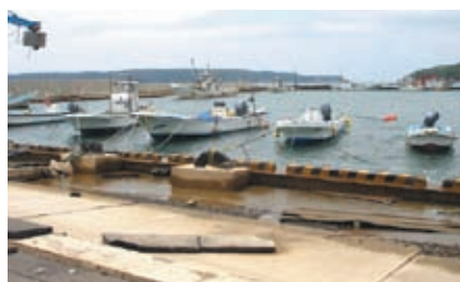
◀地盤沈下した岸壁
